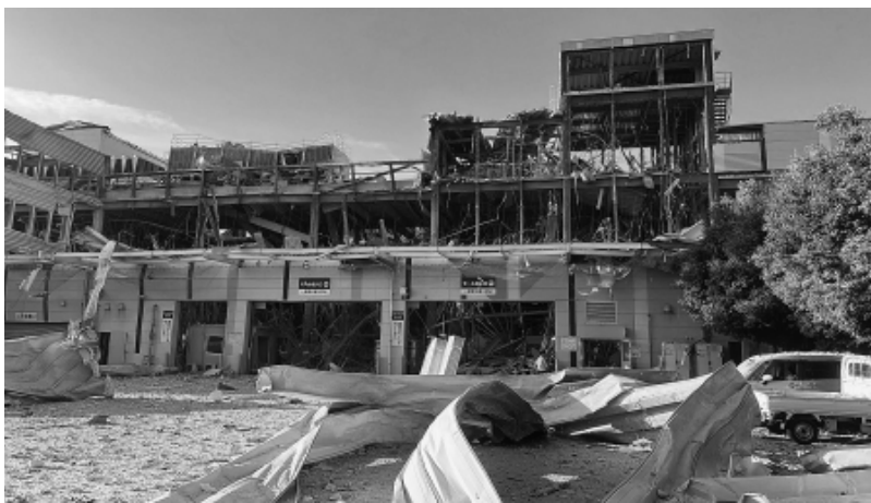
地震後、館内で爆発事故が起きて崩落した「イオンモール熊本」の外部と内部① (小松崎和弘さん提供)
